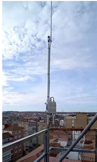
Aguas de Burgos pone en marcha una red de comunicaciones propia para impulsar la telelectura y mejorar la eficiencia en la gestión del agua
