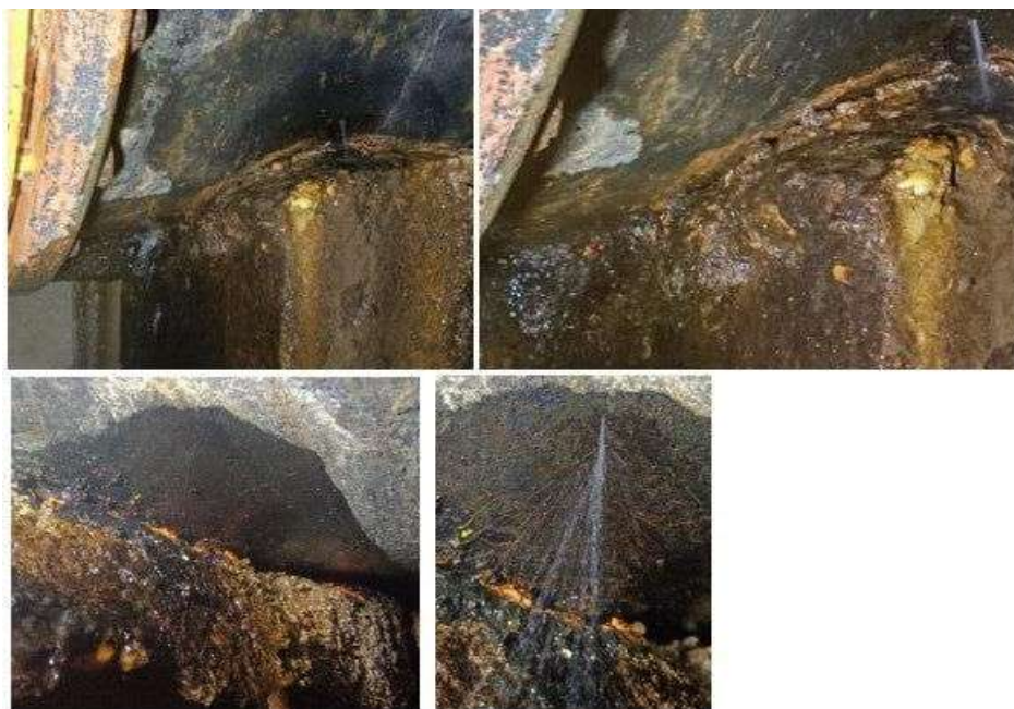
Deterioro de las válvulas de la presa de Eiras, que suministra a Vigo y a varios municipios del área. AUGAS DE GALICIA Europa Press
