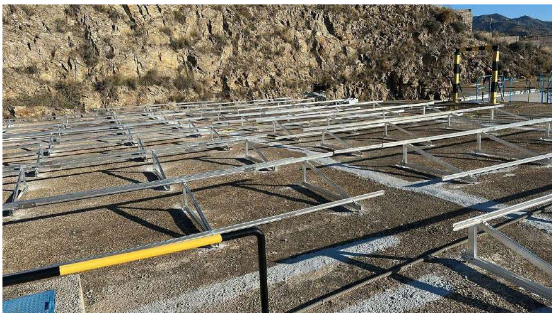
Instalación solar para autoconsumo en depósito
