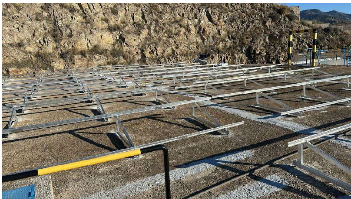
Placas fotovoltaicas en depósito de agua
